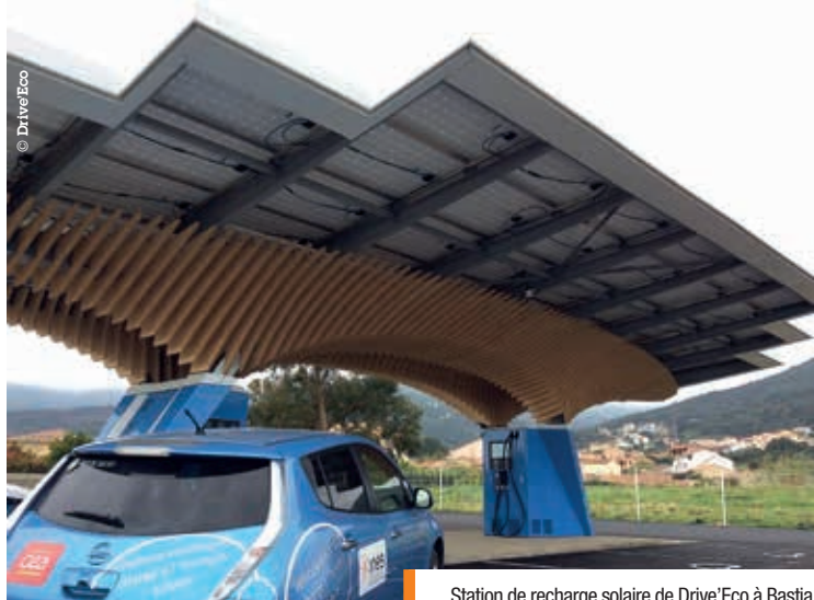
Station de recharge solaire de Drive'Eco à Bastia.
