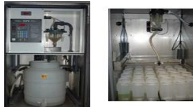
Préleveur automatique des eaux de l'égout urbain et des émissaires
