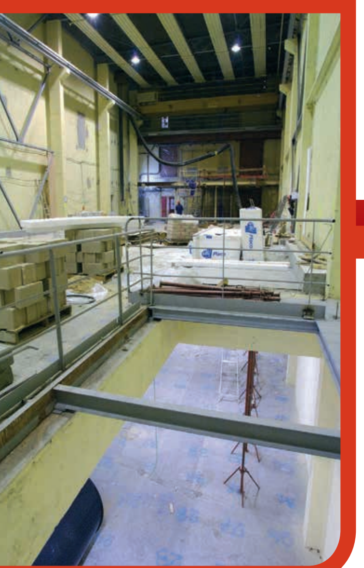
Colonnes pulsées complètement démantelées, 2005.
