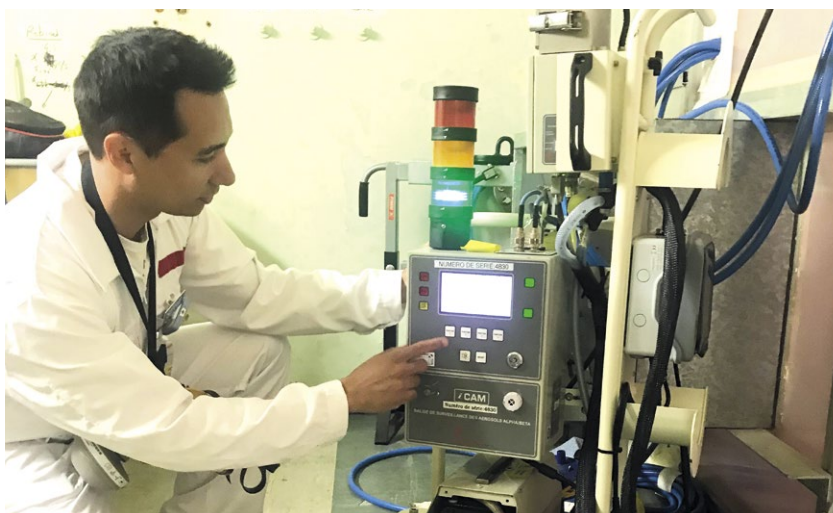
Chaque local d'une INB est équipé d'une balise de contrôle de radioactivité.
